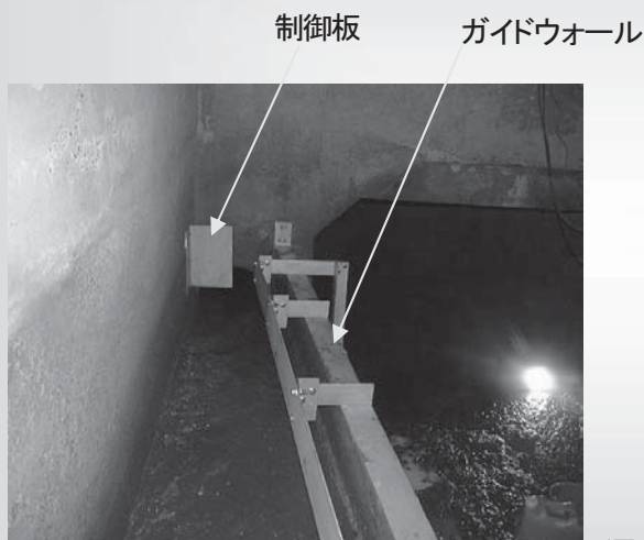
雨水吐室水面制御装置状況
